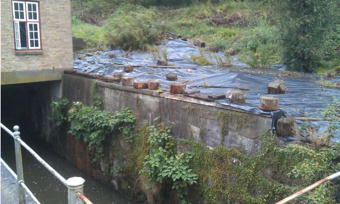
Japansk pileurt, der er vokset gennem betonmuren. Foto Martin Reimers
